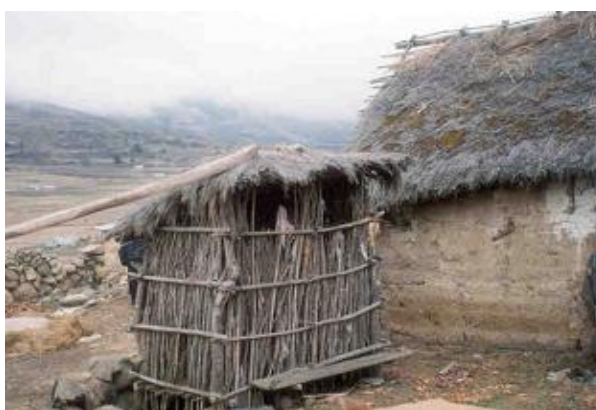
Figura 14. Almacenes “Pirwa u Oqa t'iji”, son construcciones rústicas con ramas entrecruzadas de muña, eucalipto o kewiña, en forma de pequeñas casas.
